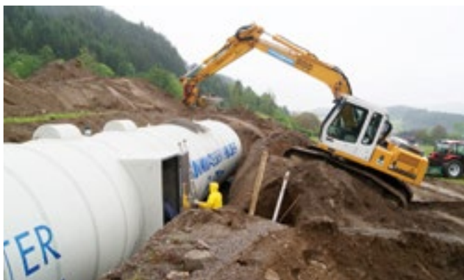
150.000 L Speicher mit mittiger Schieberkammer
