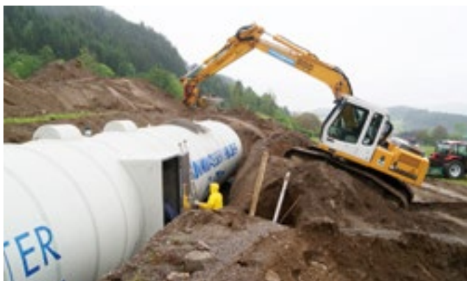
150.000 L Speicher mit mittiger Schieberkammer
