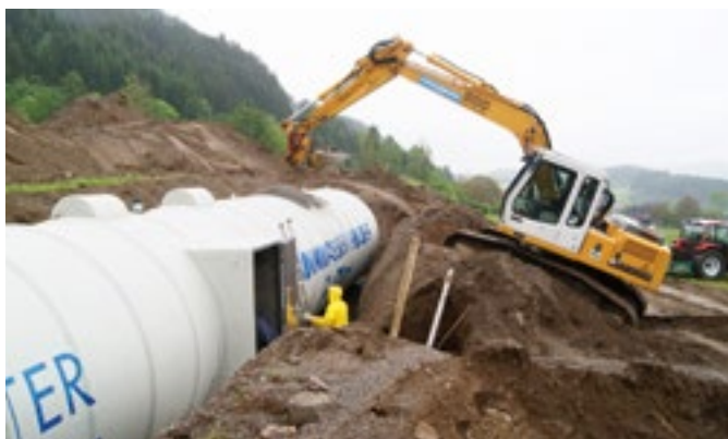
150.000 L Speicher mit mittiger Schieberkammer
