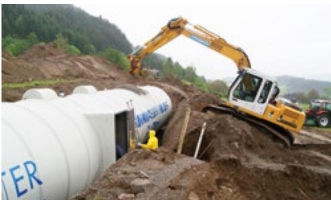
150.000 L Speicher mit mittiger Schieberkammer
