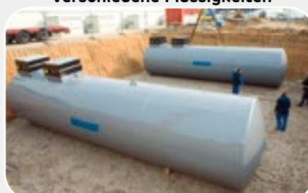
Doppelwandige Tanks für Benzin, Diesel und Heizöl
