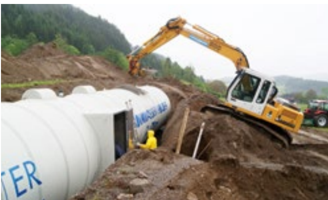
150.000 L Speicher mit mittiger Schieberkammer
