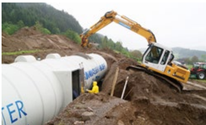
150.000 L Speicher mit mittiger Schieberkammer
