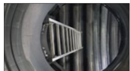
Einstiegsschacht Einstiegsleiter für Wartungsarbeiten
